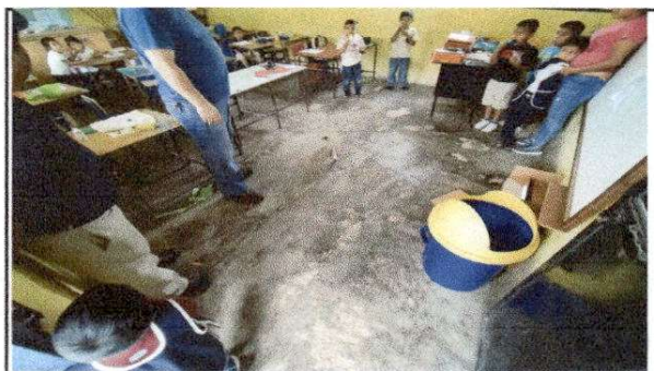
FOTO 3: Sustrución de piso de torta de concreto
