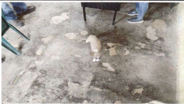
FOTO 2: Sustrución de piso de torta de concreto
